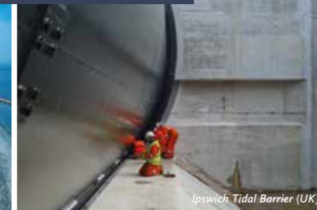
Ipswich Tidal Barrier (UK)
