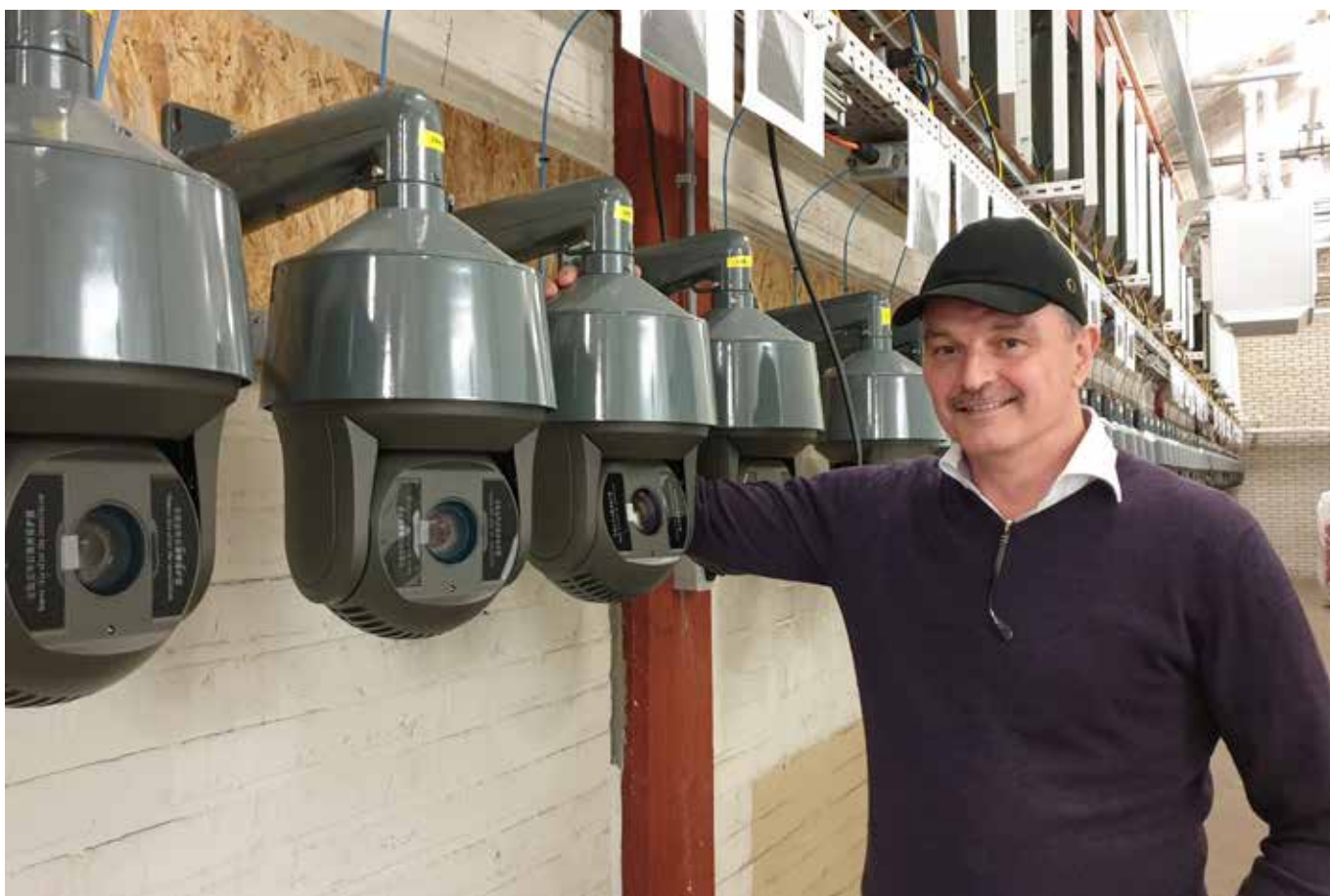
Jan Witte laat de PTZ (pan tilt zoom) CCTV camera's zien die straks de ogen van de tunnel vormen.
