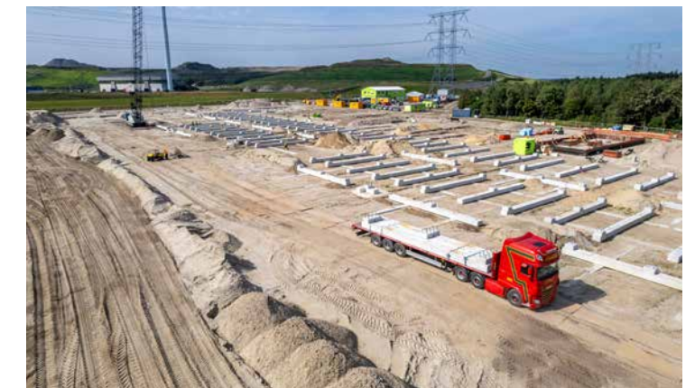
Met slimme prefab-liggers halveert Mobriq de bouwtijd voor funderingen van hoogspanningsstations. (Beeld: Mobilis)
